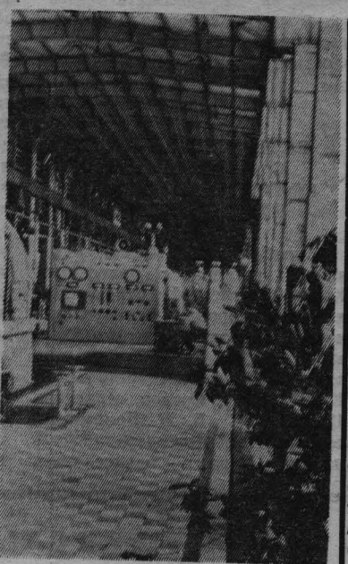
В турбинном цехе Южнокузбасской ГРЭС.
