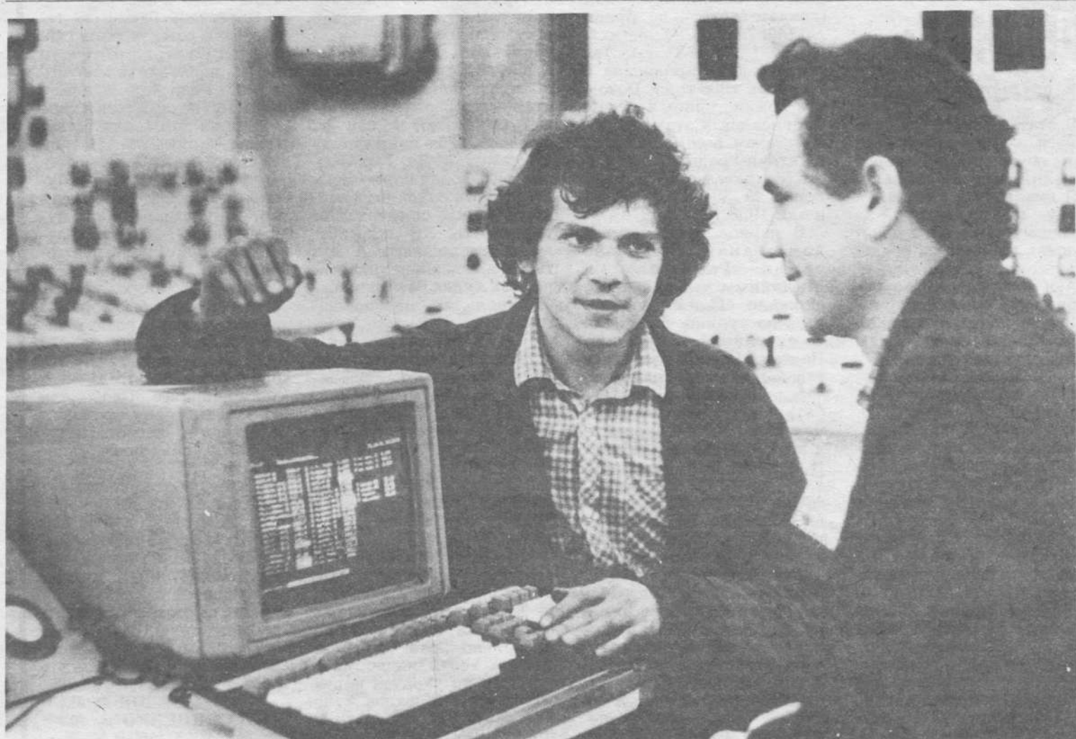
На пятом блочном щите управления котлотурбинного цеха — 200 Томусинской ГРЭС установлены первые два компьютера для сбора и обработки технико-экономической информации режима работы блоков. Сотни различных параметров должен контролировать на смене машинист. Компьютер ему значи-
