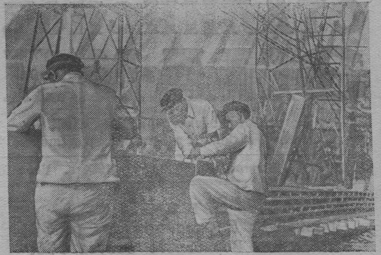
В Корейской Народно-Демократической Республике восстанавливается крупнейшая Супхунская гидроэлектростанция на реке Ялуджан (Амноккан). На снимке: изготовление железобетонных конструкций для здания Супхунской гидроэлектростанции.
