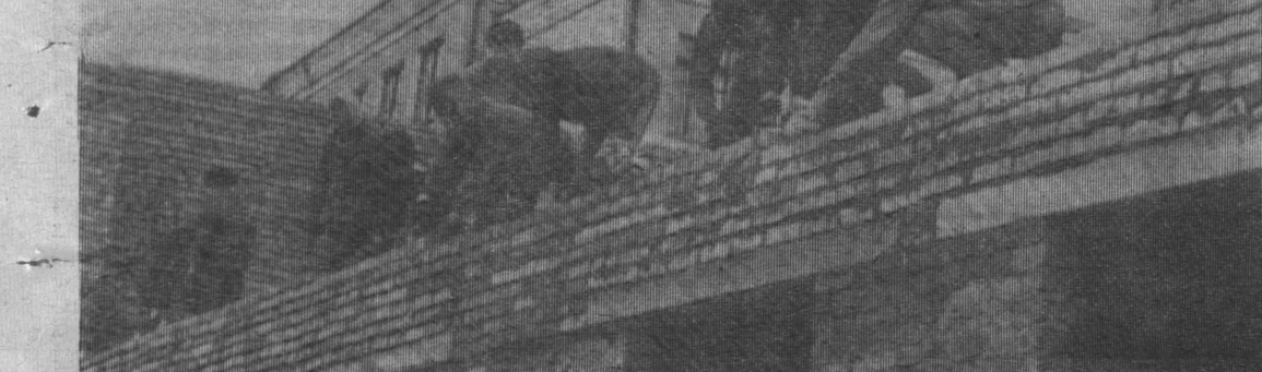
Строительство музыкальной школы на пос. Притомском ведет бригада Николая Федоровича Шахова из строительного управления Томусинской ГРЭС.
