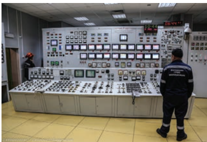
Щит управления Беловской ГРЭС (2018 год)
