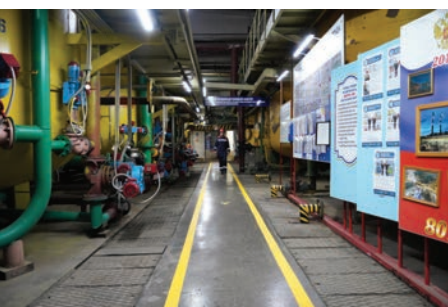
Цех химводоочистки Кемеровской ГРЭС (2023 год)
